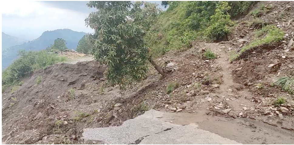
ऋषिड गाउँपालिकाको मुख्य सडक खण्ड अन्तर्गत अजम्बरी भिरमा पहिरोका कारण भाँसिएको सडक । यस भिरमा करिब आधा किलोमिटर दुरीको सडक पहिरोका कारण अवरुद्ध भएको छ । तस्विर : भज्याङ
